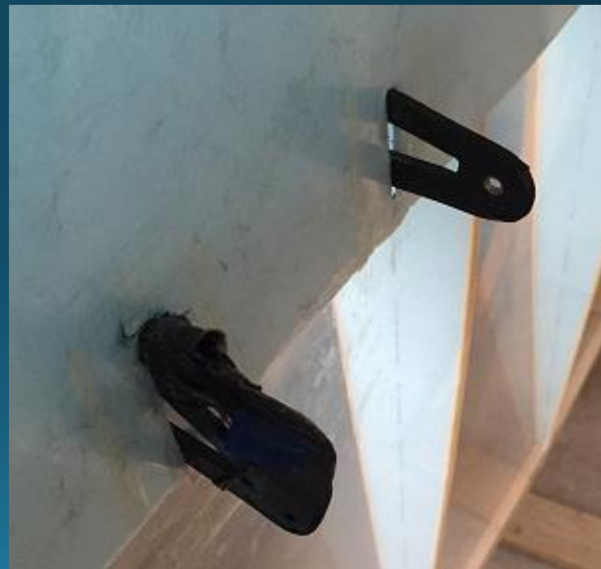
破損した取付け部
